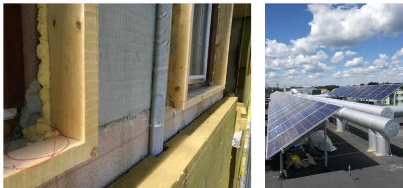
Joonis 25. Välisseina soojustuses asuv ventilatsioonitorustik ja puitraamid akende soojustuse tasapinda tõstmiseks (vasakul) ning PV-paneelid (paremal).
